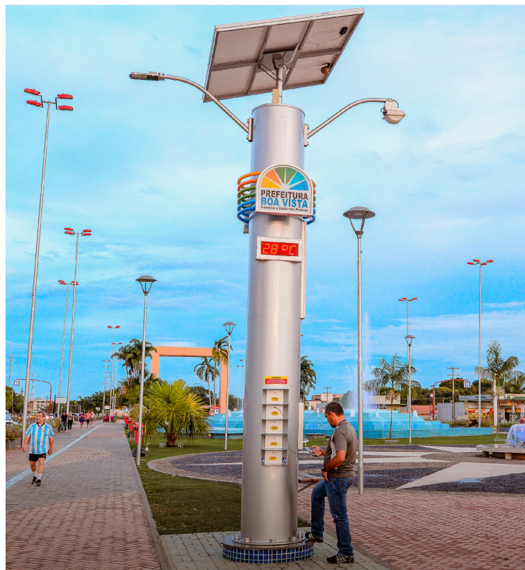
Iluminação pública com energia solar fotovoltaica.
